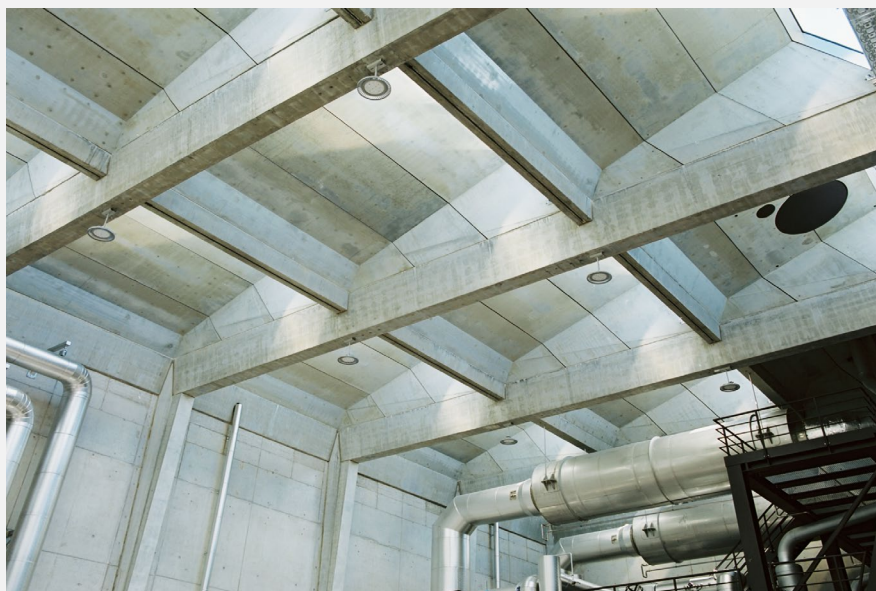
Fernwärmezentrale Waldau, St. Gallen (Foto: Katalin Deér)
