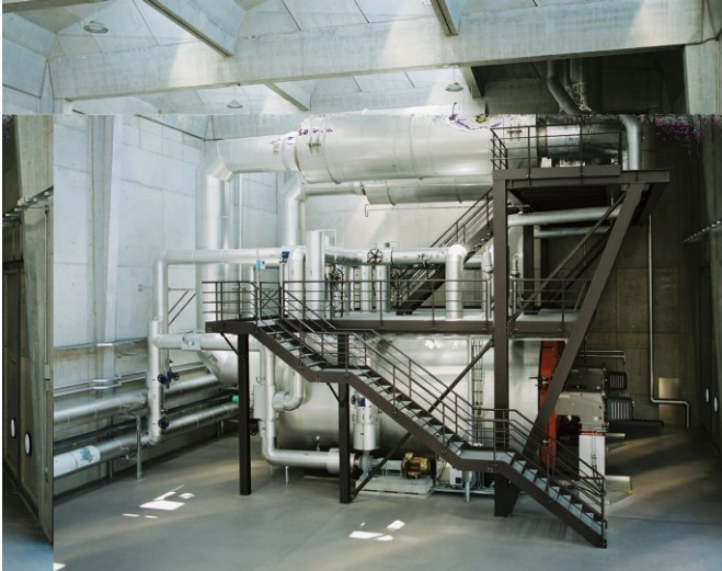
Bild 7 Kesselpodest Steel platform
